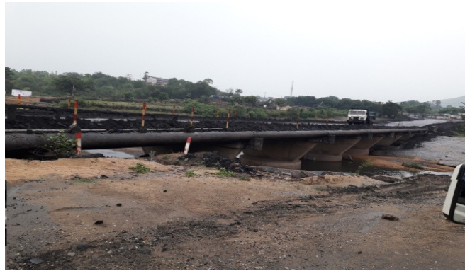
तस्वीर 08: पैरा सं. 5.7.1: सीसीएल के पिपरवार ओसीएम में सफी नदी के पुल के किनारे जमा कोयला ओवरलोड ट्रकों से रिसाव
